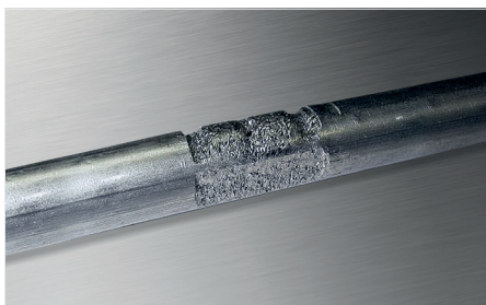
Spaltkorrosion unter einem üblichen Schellenkörper
